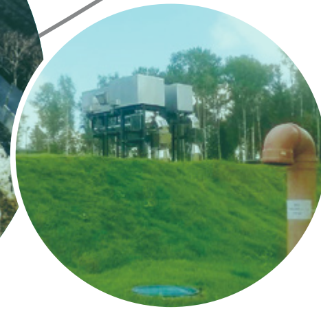
Системы Аэролайф-гидро КФЗ-300НКСАД и КФЗ-750НКСАД на железобетонном полузаглубленном РЧВ
